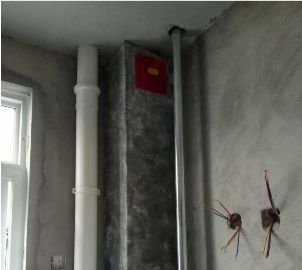
图4.2-2厨房排油烟管道
